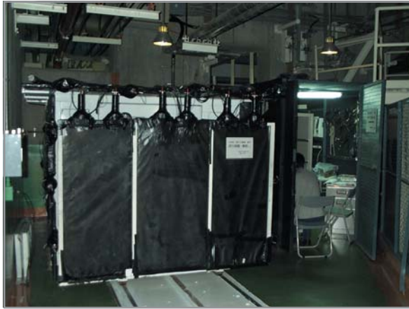
圖三：國聖微中子實驗室外觀，可見屏蔽體及控制室。
